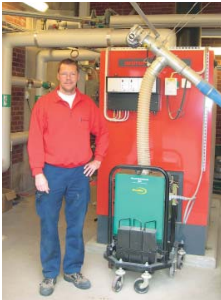
– Vi har inte haft mer tekniska problem med panncentralerna för pellets än med andra, säger Michael Johansson, på Riksbyggen Energi.
